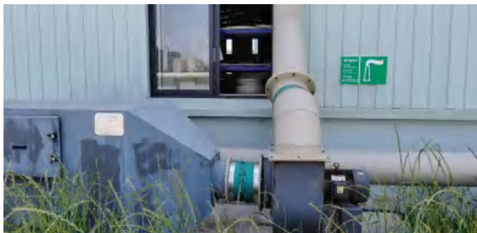
挤出、焊接废气排气筒标志牌
