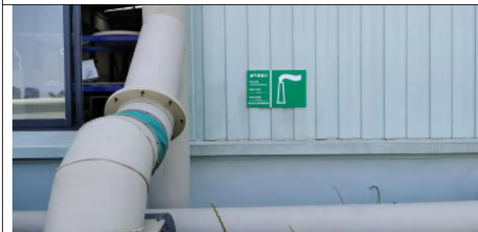
金属焊接废气排气筒标志牌
