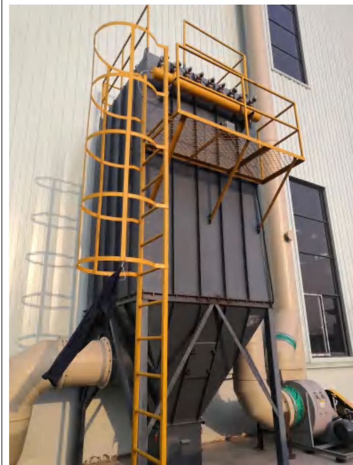
布袋除尘器及排气筒
